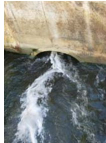
36 inch effluent line
